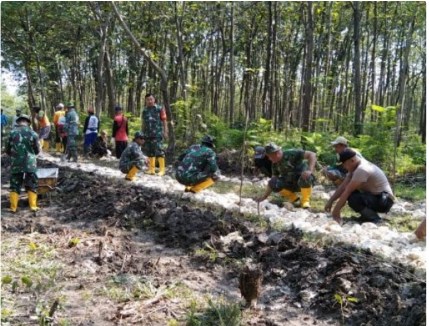
Satgas TMMD bersama warga terus berjibaku dengan drum truk menurunkan material batu di lokasi TMMD
